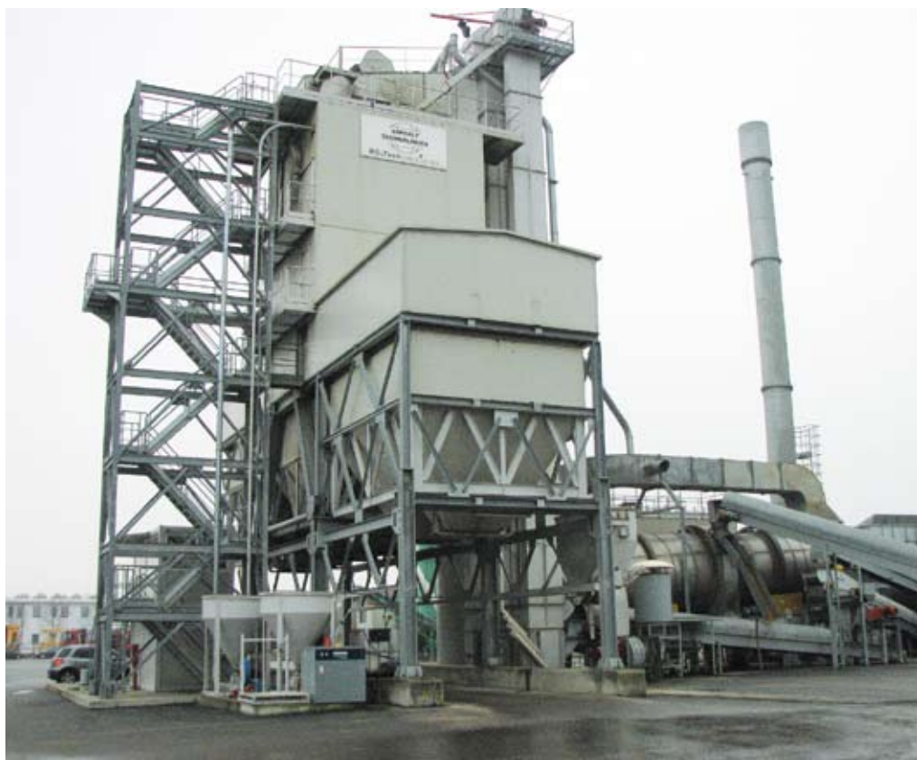
L'impianto di produzione asfalto realizzato dalla Asphalt Technologies per l'Impresa Bacchi
